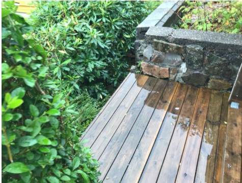
Bildet viser manglende rekkverk.
